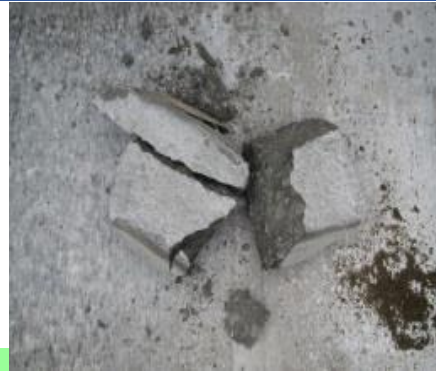
②通常生コン硬化処理の破壊
